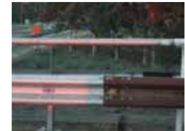
FOTO In het nieuwe zinkwerk wordt het avondrood fraai weerspiegeld; de tientallen jaren oude geleiderails ernaast kan na het herverzinken opnieuw gebruikt worden.
